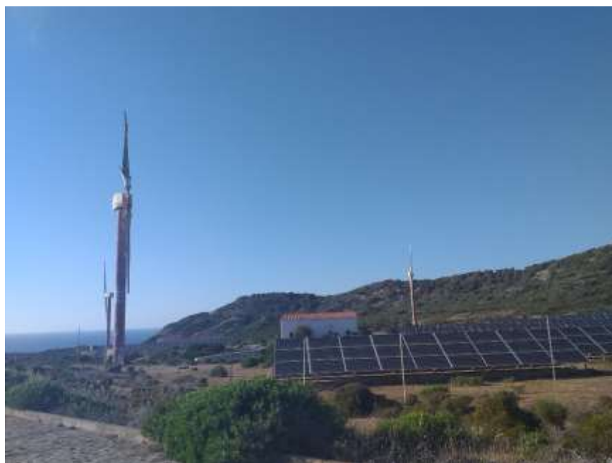
Figura 12 Foto dell'impianto di Nasca dalla quale sono visibili le tre pale eoliche non più funzionanti (ma non dismesse) e l'impianto fotovoltaico regolarmente in funzione.
